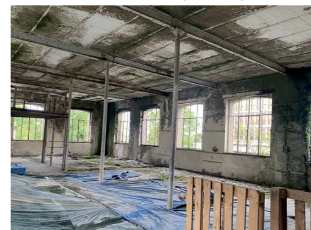
Etat actuel - dégradation
